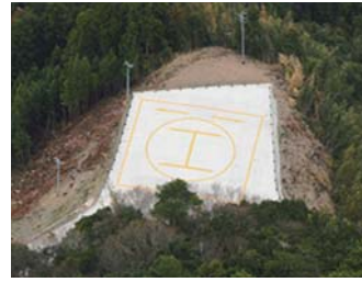
コンクリート舗装+マーキング 航空灯火設備
