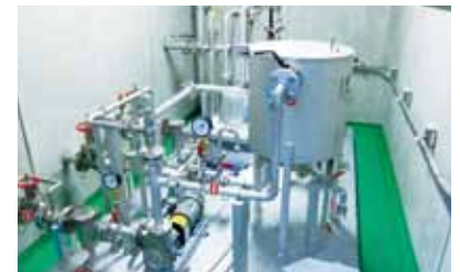
② ポンプユニット
