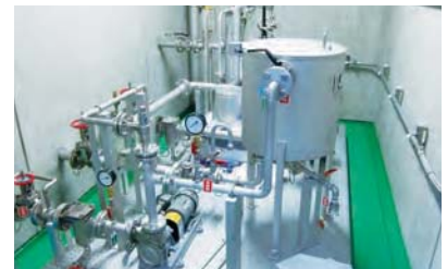
② ポンプユニット
